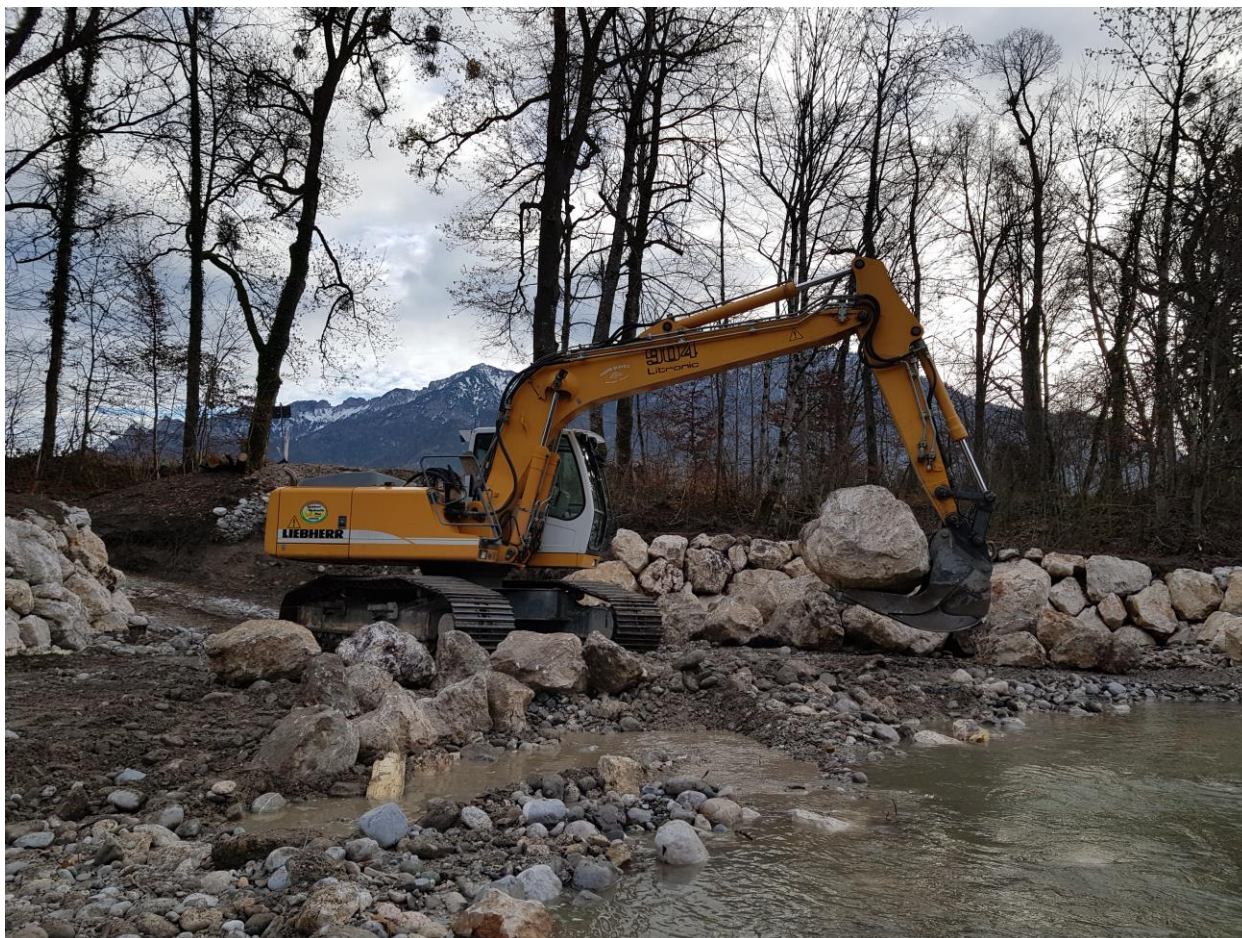
Abb. 1: Ein Bagger hebt einen der bis zu fünf Tonnen schweren Wasserbausteine an die richtige Stelle.
